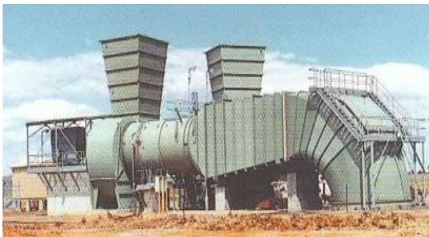
Рис. 2. Эксплуатация ГВУ для вентиляции подземного рудника без размещения в здании.
